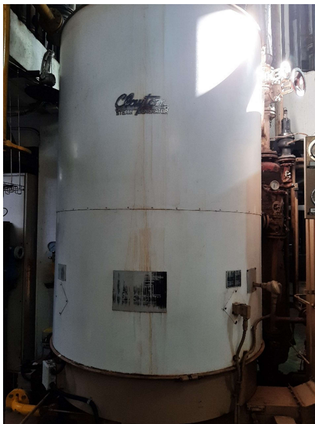
Ilustración 22 Calderas de generación de vapor
