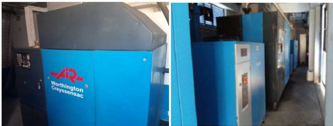
Ilustración 24 Sistema de aire comprimido
