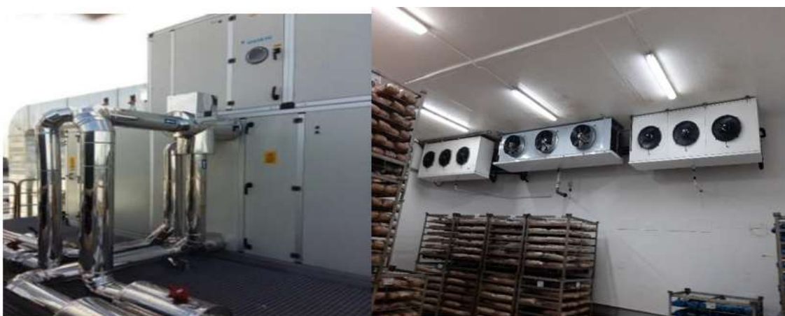
Ilustración 26 Equipos de climatización
