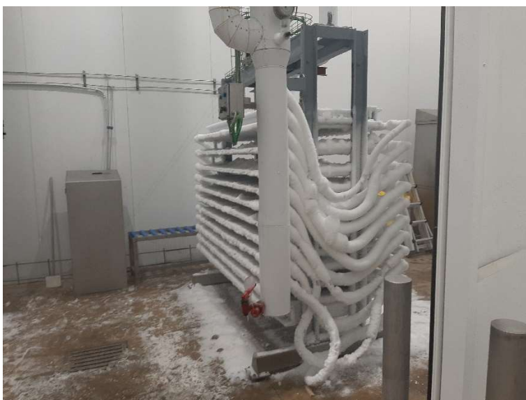
Ilustración 25 Sistema de frío industrial
